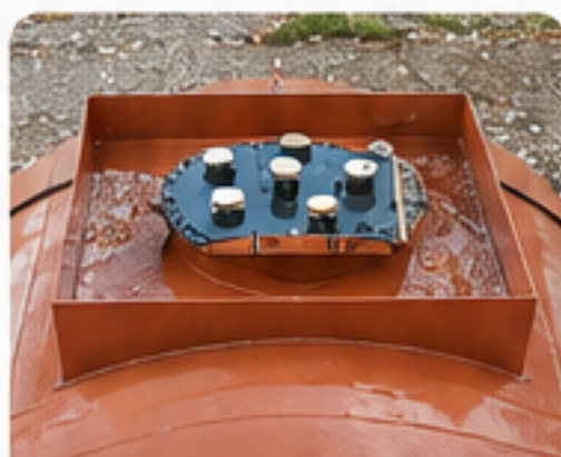
ÉQUIPEMENTS HAUT DE CUVE
