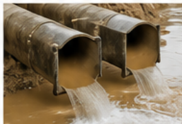
ÉVACUATION D'EAUX USÉES
